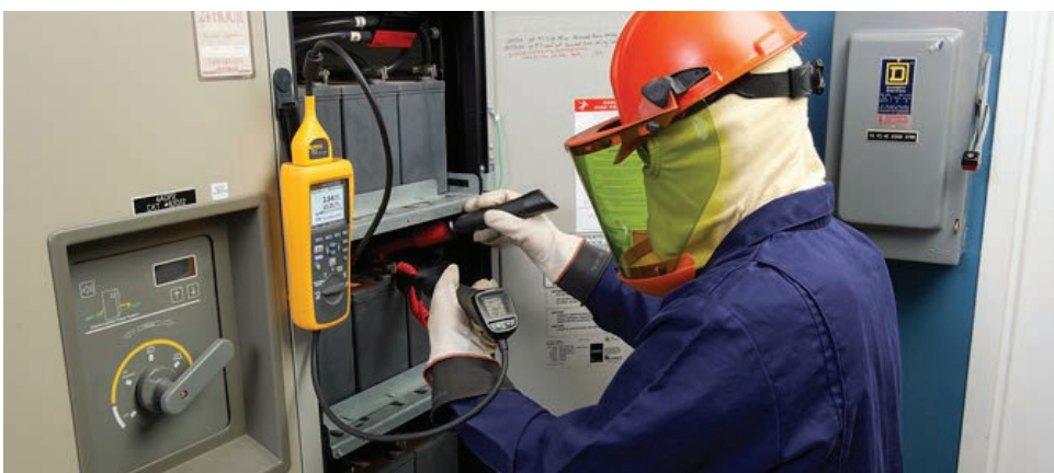
Einsatz des Fluke BT52X bei der Impedanzmessung zur vierteljährlichen Prüfung des Zellen-Innenwiderstands
